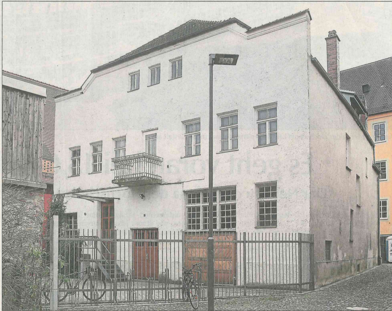
Dem trapezförmigen Gebäude steht die Sanierung unmittelbar bevor. Darin werden Wohnungen mit viel Licht und Platz entstehen.
